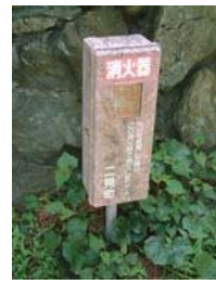
〈33〉消火器格納箱
