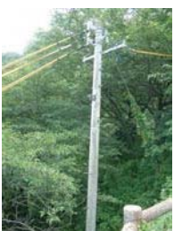
〈28〉電柱（音無山公園）
