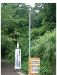
〈29〉配電支柱1（音無山公園）
