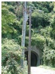
〈37〉配電支柱 2 (音無山)
