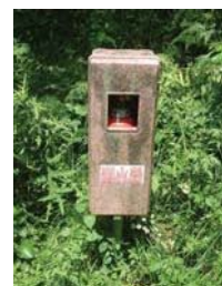
〈30〉消火器格納箱
