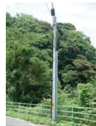
〈37〉配電支柱 1 (音無山)
